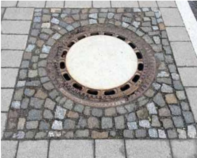
Abb. 110 Schachtdeckel Guss und Beton
