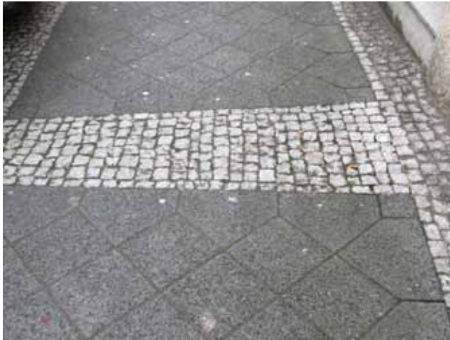
Abb. 47 Winkelausgleich im Betonpflaster durch Keile, Leipzig
