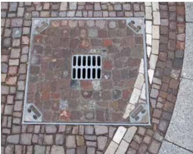
Abb. 87 Schachtdeckel rechteckig, ausgeplastert
