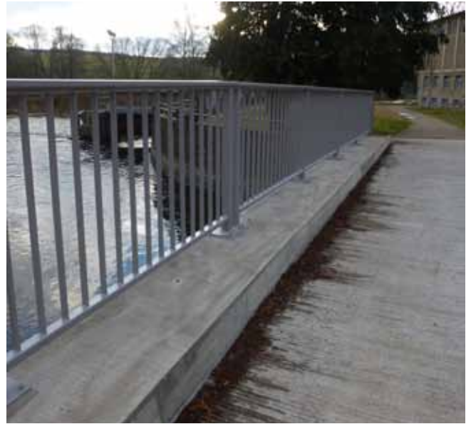
Abb. 40 Absturzsicherung Brückenbau, pulverbeschichtet in RAL- oder DB-Farbe
